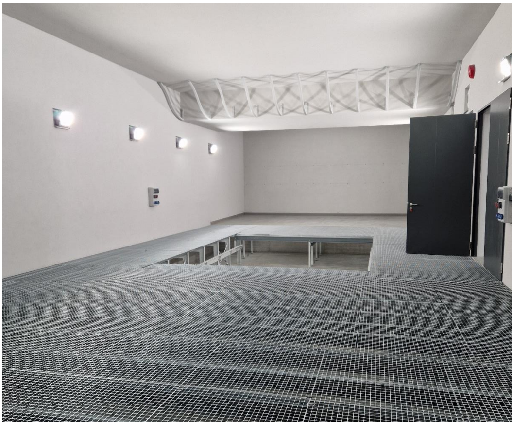
Tunel TA.2.D Elementy wyposażenia specjalistycznego – podłoga techniczna oraz kierownice i zaokrąglenia naroży
